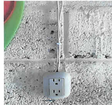
Foto 4: Sistema Eléctrico de la cocina
