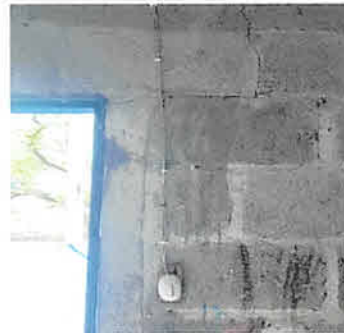
Foto 6: Sistema Eléctrico de la cocina
