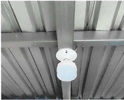
Foto 3: Sistema Eléctrico de la cocina
