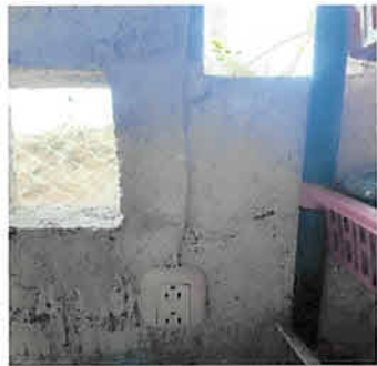
Foto 5: Sistema Eléctrico de la cocina
